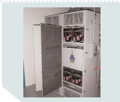
ПРИТОЧНЫЙ МОДУЛЬ PURAFIL В ВАЛЬЦЕШЛИФОВАЛЬНОЙ КОМНАТЕ
