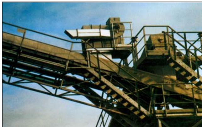
INFA-JET Вентиляционный фильтр на передаточном конвейере.
